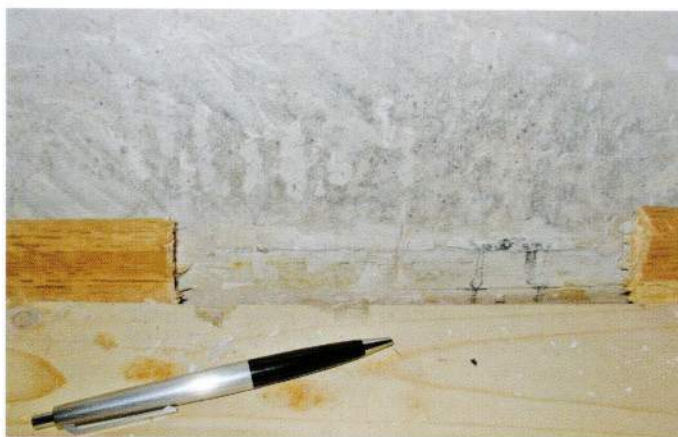
Eine mangelhaft gedämmte Kellerdecke kann ein Grund sein, dass sich Schimmelpilz in die Dämmebene des Fußbodens einnistet.
