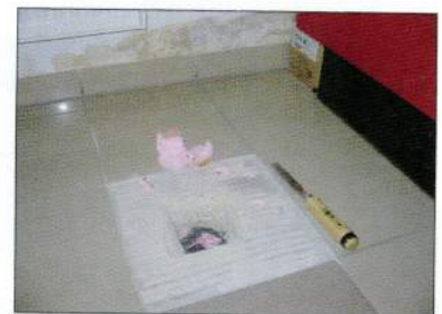
Neben der Wand ist auch die Dämmebene unter dem Estrich mit Schimmelpilzen belastet
