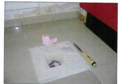
Neben der Wand ist auch die Dämmebene unter dem Estrich mit Schimmelpilzen belastet
