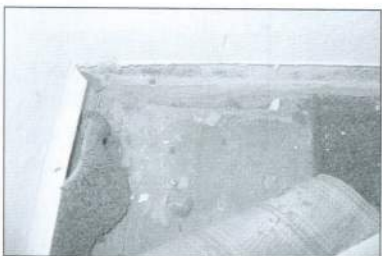
Saniert wurde nur die belastete Wand über der Fußbodenrandleiste: Weitere Schimmelpilzbelastungen hinter der Sockelleiste und im Unterboden
