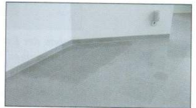
Belastete Unterböden: Eines der wenigen Beispiele, bei denen ein Wasserschaden mit nachfolgendem Schimmelpilzbefall im Unterboden „sichtbar“ wurde
