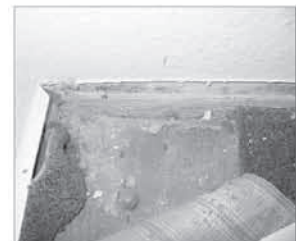
Saniert wurde nur die belastete Wand über der Fußbodenrandleiste: Weitere Schimmelpilzbelastungen hinter der Sockelleiste und im Unterboden
