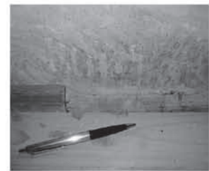
Eine Schimmelpilzbelastung des Unterbodens ist bis zur Randfuge vorgedrungen
