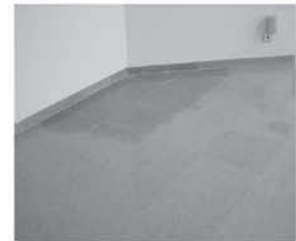
In einem Neubau: Wasserschaden mit nachfolgendem Schimmelpilzbefall im Unterboden Fotos: Autor
