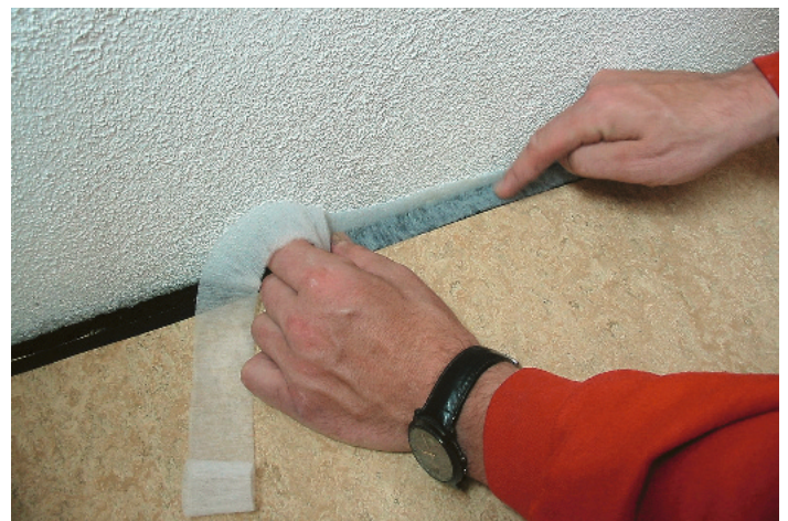
Über die Fuge wird ein weißes Hochleistungsfiltergewebe zur Partikelfiltration gespannt
